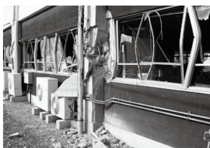
座屈全壊した市庁舎中央館
