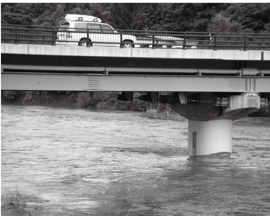
台風12号によって増水した猿ヶ石川(下鱒沢・沢田橋)
