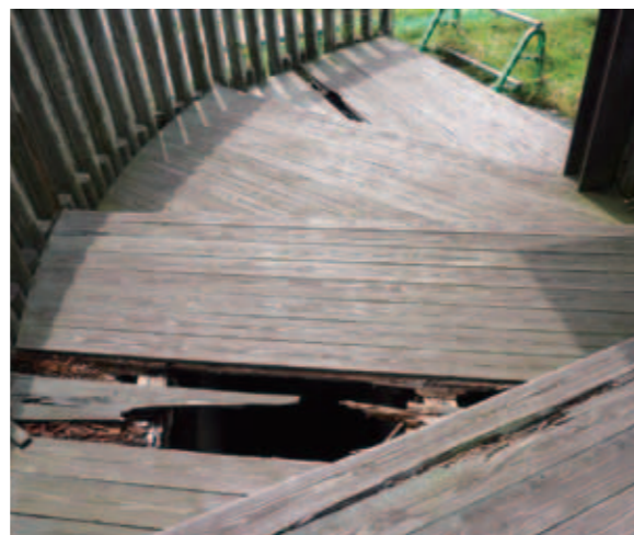
床板に穴があき、立ち入り禁止となっている寺沢高原の展望台
