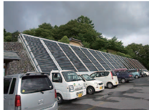
水光園の太陽熱システム
