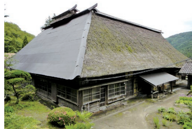
経年劣化で主屋のかやぶき屋根が傷み、鉄板で覆う
