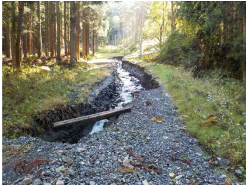
令和元年10月の台風19号による被害の様子
