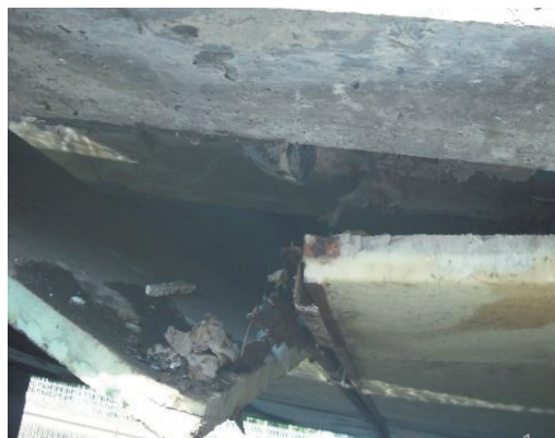
老朽化が目立つ入浴施設下部
