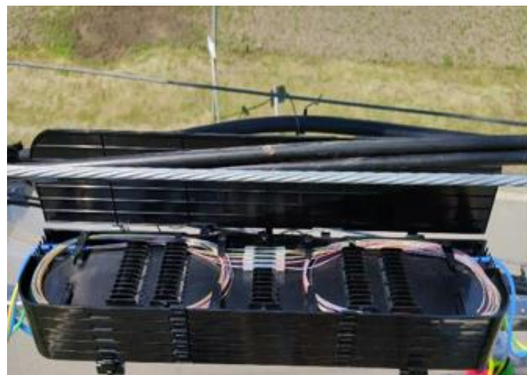
光ファイバケーブル接続用クロージャージャー内部
