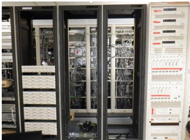
遠野テレビ内機器設置用ラック
