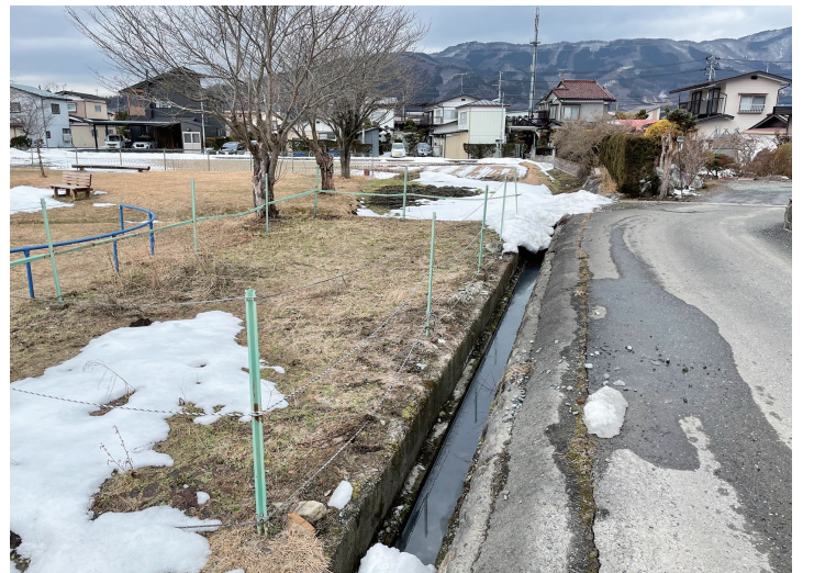
異臭など衛生面で早期の改良が望まれる水路の一例
